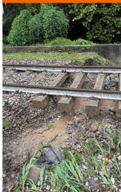
I danni alla linea ferroviaria causati dall'alluvione del 10 settembre 2025.
